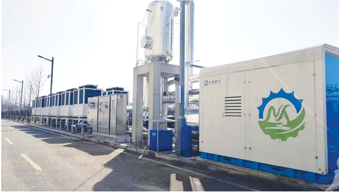
图 为山东力诺瑞特新能源有限公司的空气源热泵。
