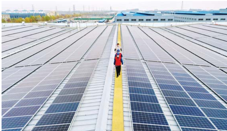
光伏发电正在山东大面积推广。图为位于临邑县的一个屋顶光伏电站。
